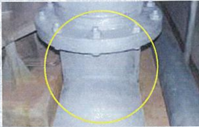
地下設備内配管
