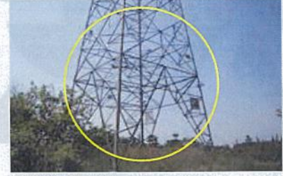
送電鉄塔本体
