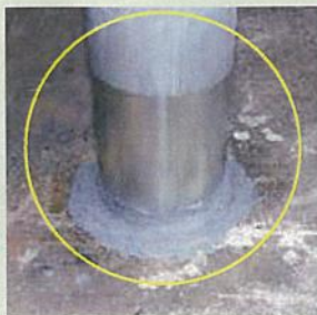
銅製街灯地際部
