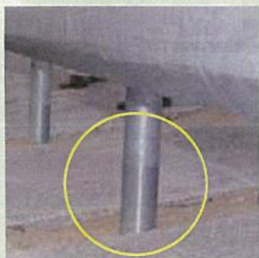
ガードレール支柱地際部
